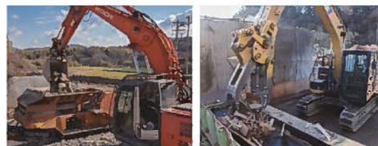
破碎施設①
